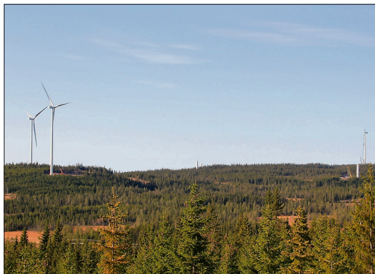
RUVER: Ferdige og halvferdige vindturbiner ruver høyt over skogen i Kjølberget.
