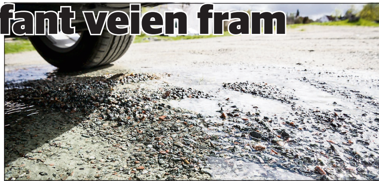
LEKKASJE: Klart vann pipler opp av bakken på den gamle hustomta ved krysset Sofies gate og Engens gate.
