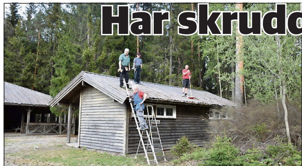
SKRUR TIL: Roy Bråthen på stigen med dugnadsmenn på taket; Stein Skyrudsmoen, Per Ole Hveberg og Jan Hemsæter.
